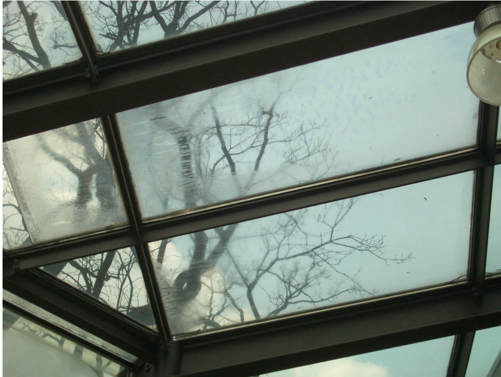
Bild 1: Kondensatwasserbildung im Scheibenzwischenraum von Isolierverglasungen in einer Glasdachkonstruktion
