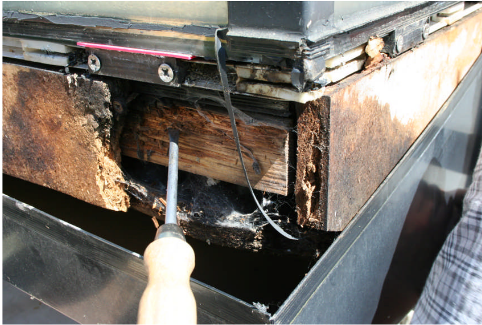
Bild 3: Auswirkung einer mangelhaften Falzraumentwässerung
