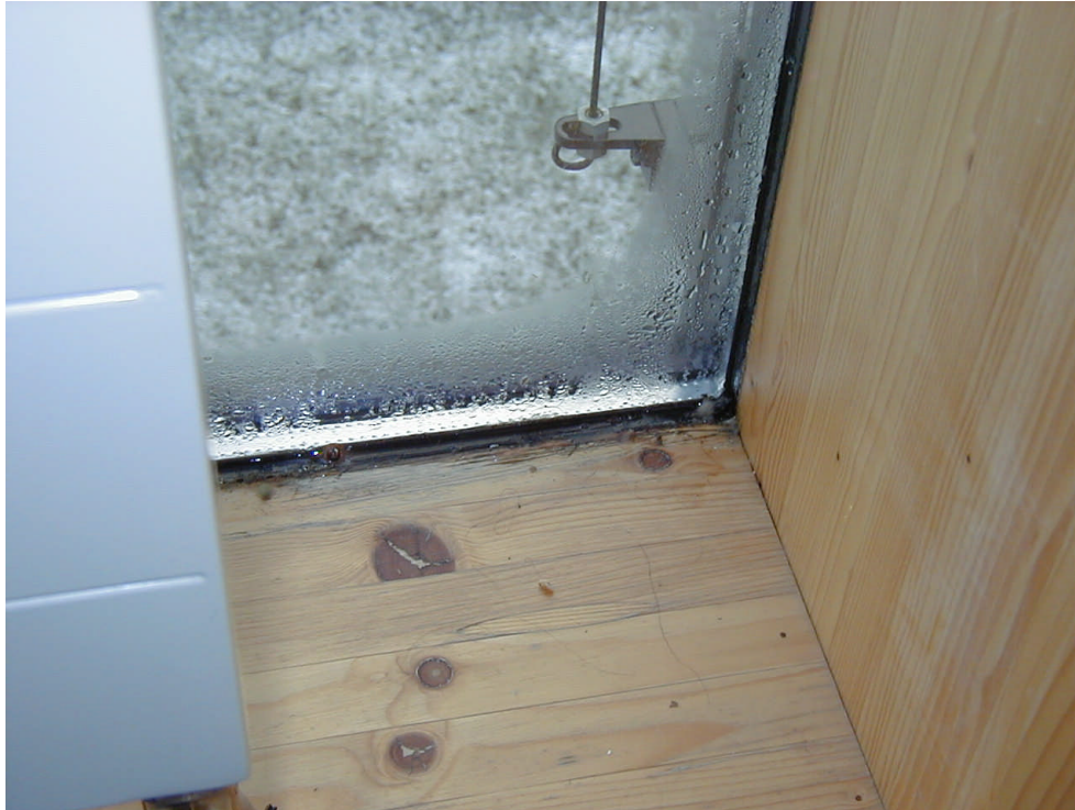
Bild 2: Kondensatwasserbildung auf der raumseitigen Oberfläche einer Isolierverglasung
