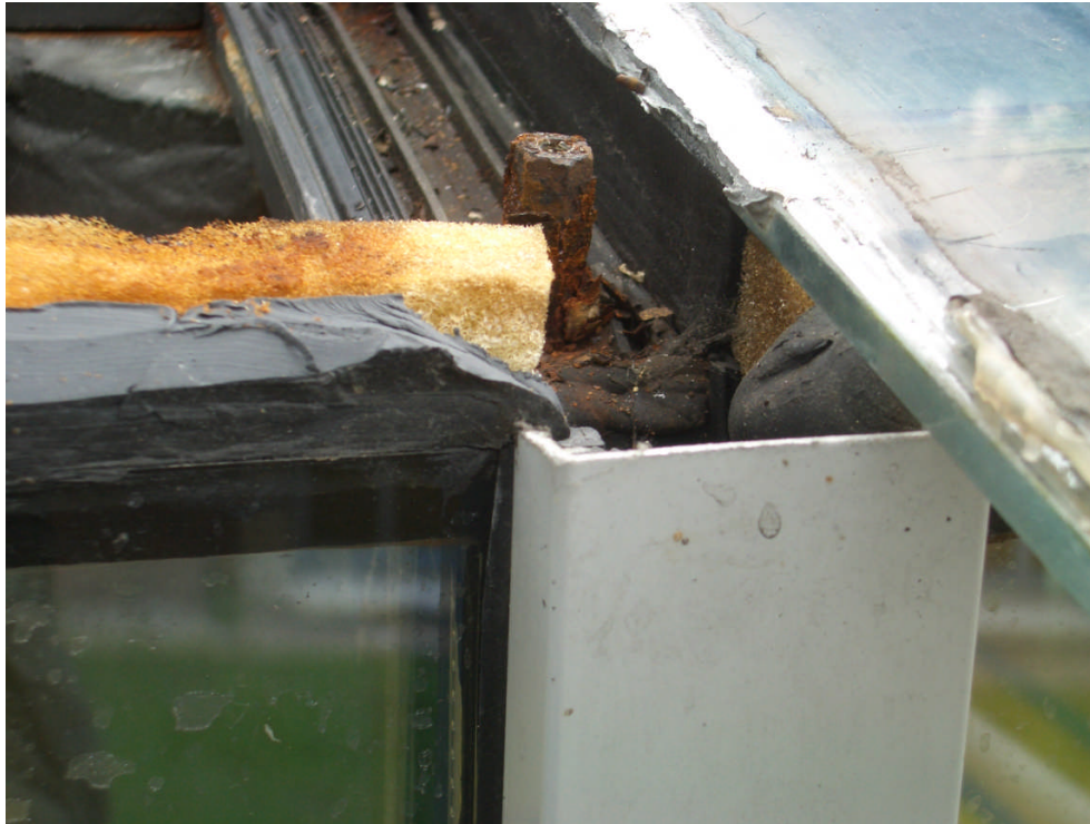
Bild 5: Zerstörende Korrosion durch Wärmedämmung im Falzraum
