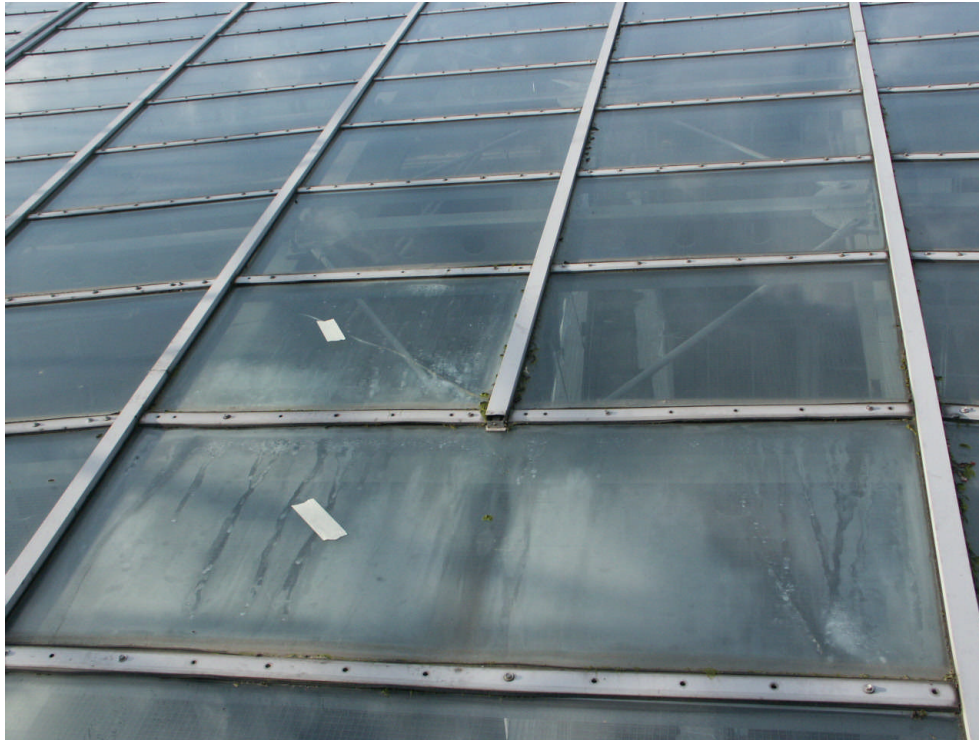
Bild 4: Glasdachkonstruktion mit mangelhafter Falzraumtzwässerung im flach geneigten Dachbereich
